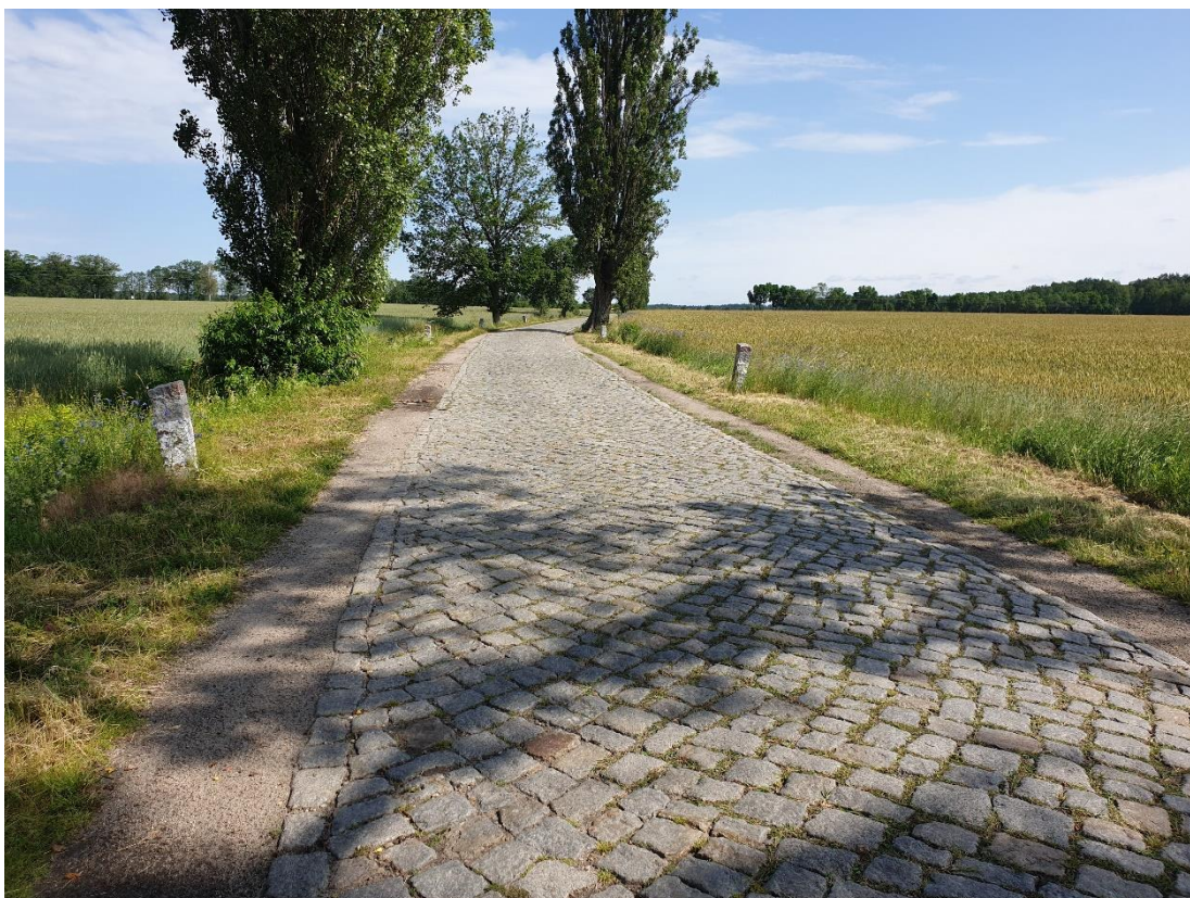
Publiczna droga gminna nr 2703F w nawierzchni z kostki kamiennej – kamienne słupki prowadzące
