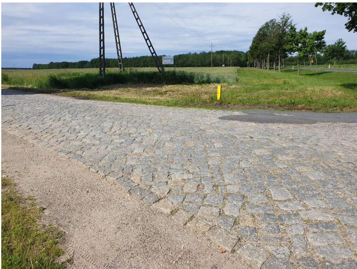
Zjazd z drogi publicznej 2703F na istniejącą drogę krajową nr 12 – widok w kierunku na drogę gminną
